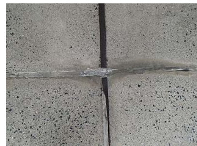
目地棒の欠損・閉塞
